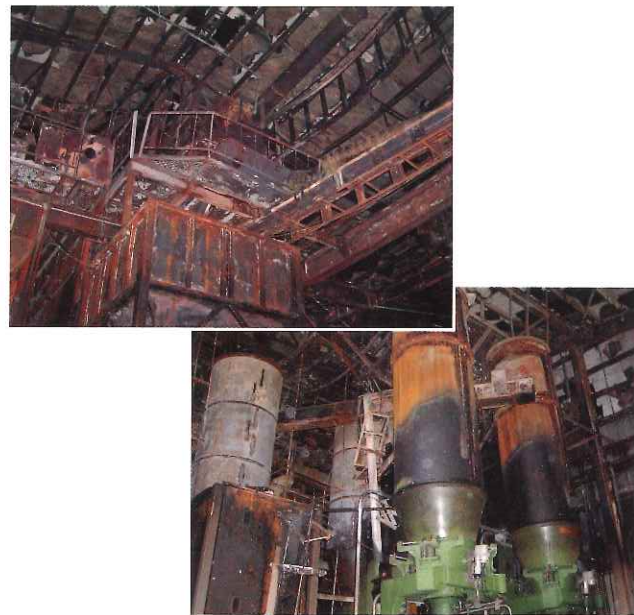
全焼した第二工場
